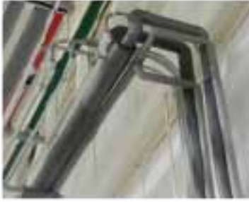
Aislante térmico en líneas de refrigeración comercial e industrial.
