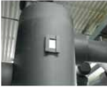
Aislante térmico en tanques y calderas de sistemas de agua caliente.
