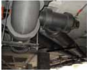
Aislante térmico en sistemas de agua helada.
