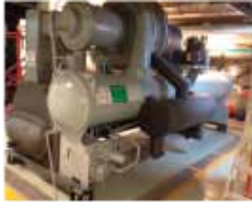
Aislamiento térmico en chillers.
